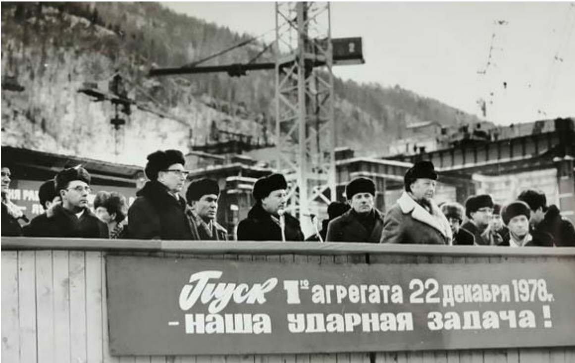
На строительстве Саяно-Шушенской ГЭС. Слева Григорьев Ю.А., Иванцов Н.М., Садовский С.И., Масловский Г.Ф., Пупков Г.Г.
